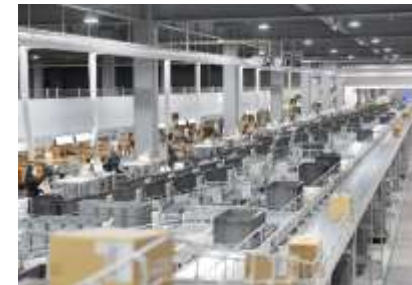
荷姿変換ステーション
